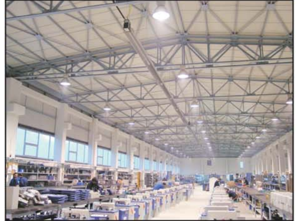
Fabrika Uygulaması: Düz Tip Çok Yakıclı Sistem-Genel Isıtma
