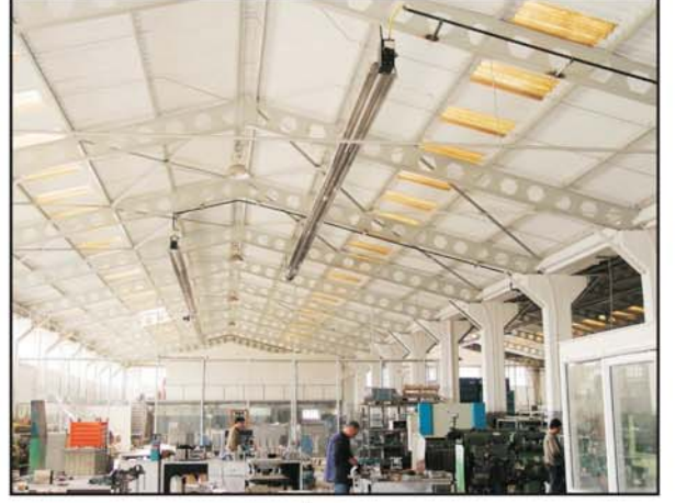
Fabrika Uygulaması: Düz Tip Üniter Sistem-Genel Isıtma
