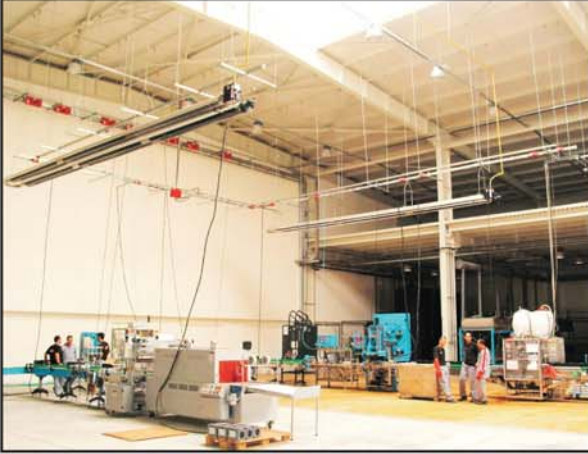
Fabrika Uygulaması: U Tip Üniter Sistem-Lokal Isıtma
