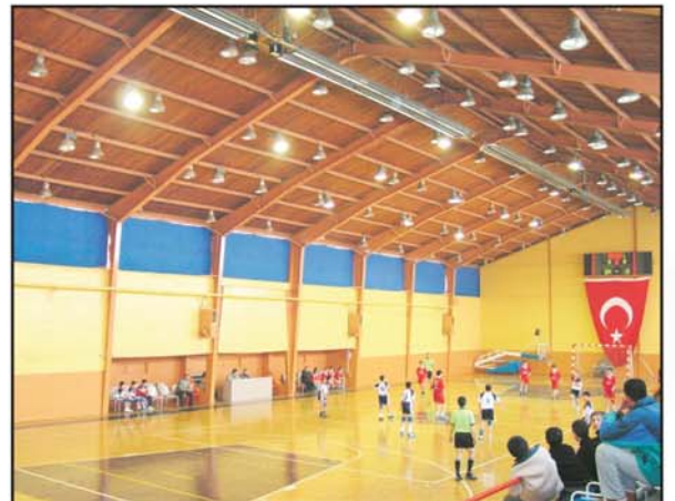
Spor Salonu Uygulaması: U Tip Üniter Sistem-Genel Isıtma
